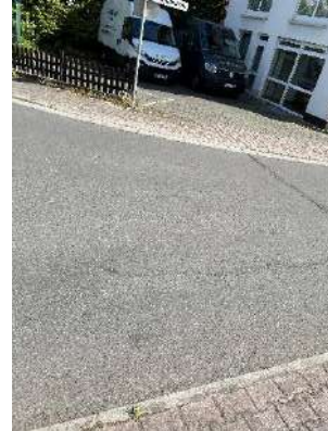
Abbildung 81: Fehlende taktile Leitelemente an der Einmündung „Emminghausstraße/ Frankfurter Straße (B456)“ (Mangel Nr. 102)
