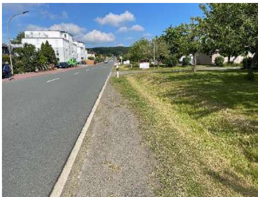
Abbildung 32: Fehrender Gehweg an der Weilburger Straße (B 456)
